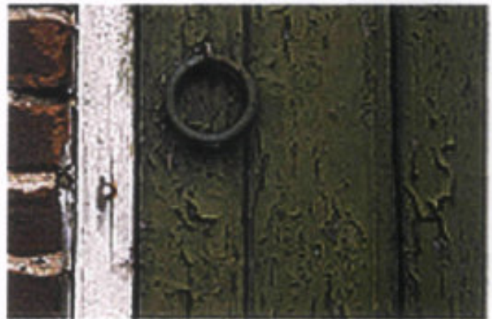
Peeling Door Paint
